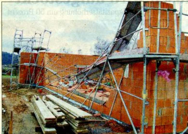
Der Sturm hinterließ eine Spur der Verwüstung.
